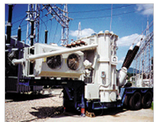
이동용 변압기(3상 154kV 40MVA)
